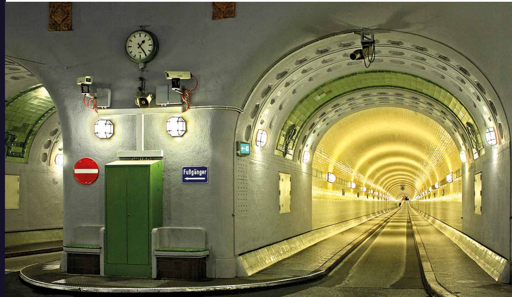
Wandleuchten als Einzelfertigung, alter Elbtunnel, Hamburg
